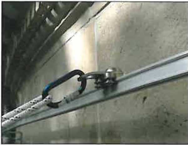
Descente toiture - entretien / Chariot adapté
