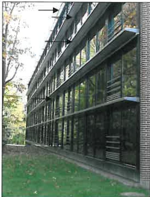
Accès balcon - nettoyage vitre
